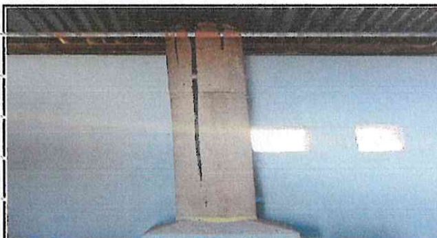
Foto 4: Chimenea en mal estado
