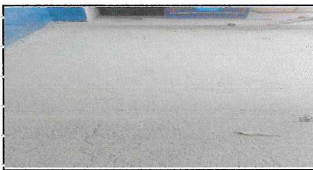
Foto 6: Piso de cemento líquido en mal estado corredor de la cocina
