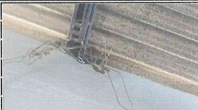
Foto 2: Cables eléctricos en mal estado
